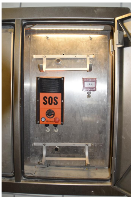
Figur 5-32: Nødstation vist uden pulverslukkere (NHV)
