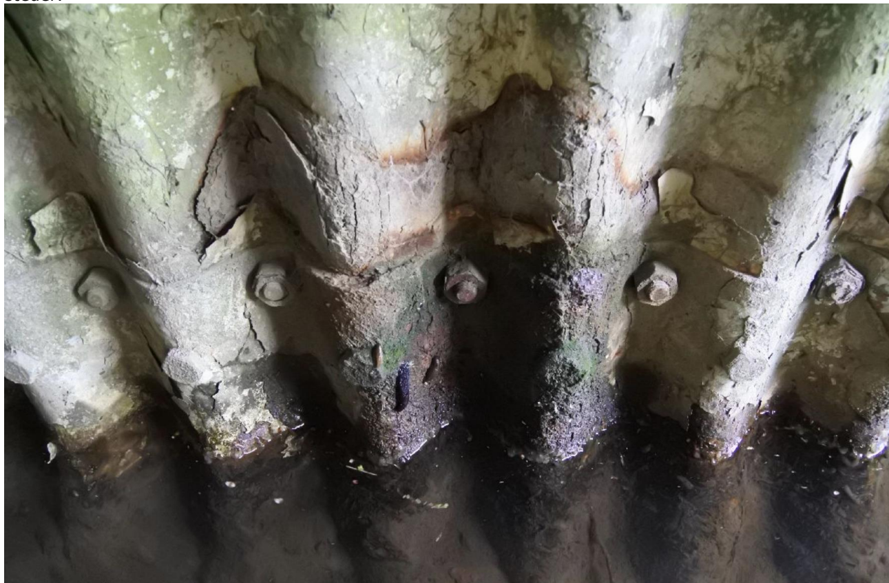
Figur 1: Endeunderstøtninger, med svær korrosion og gennemtæring, udklip fra generaleftersynsrapport 2023.
